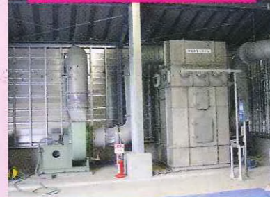
一次発酵機内空気量調整 (臭気処理)
